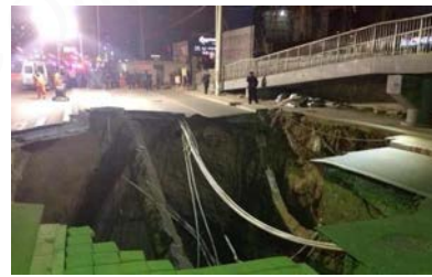
4.4 北京地铁工地塌陷事故
